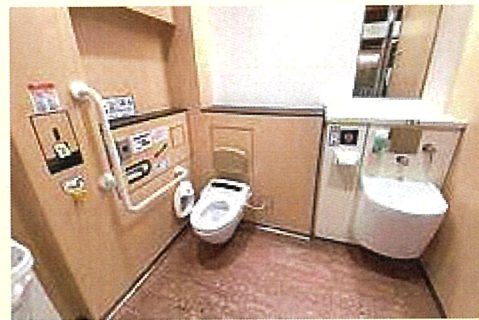
オストメイト対応設備
